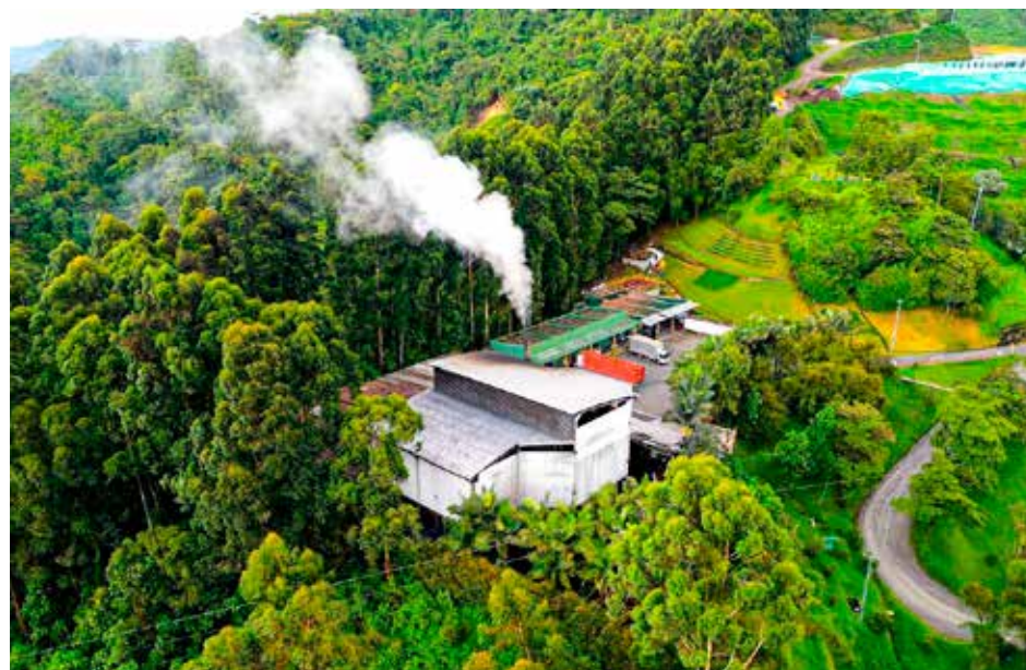
Horno quemador de biogás instalado en el Parque Tecnológico La Esmeralda por Emas by Veolia. Un proyecto que acaba de ganar el premio nacional a la Eficiencia energética convocado por Andesco y el Ministerio de Minas. (Foto cortesía Emas by Veolia)
